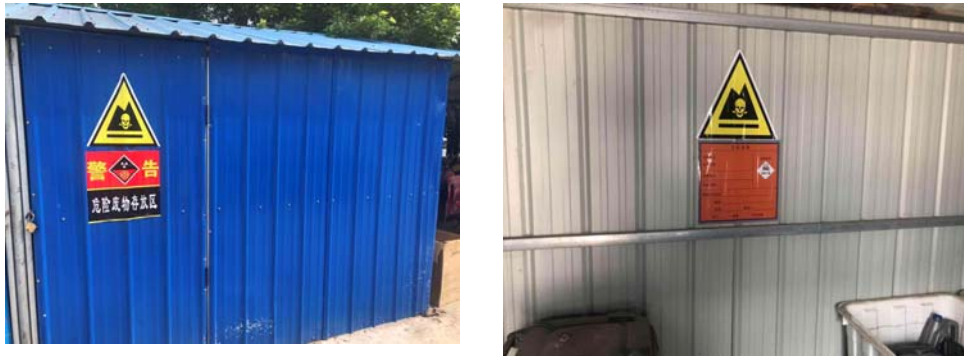
图7项目危废暂存间照片
