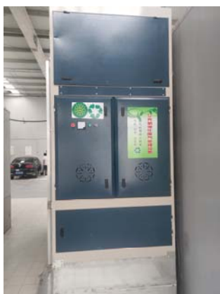
2#漆房废气治理设备
