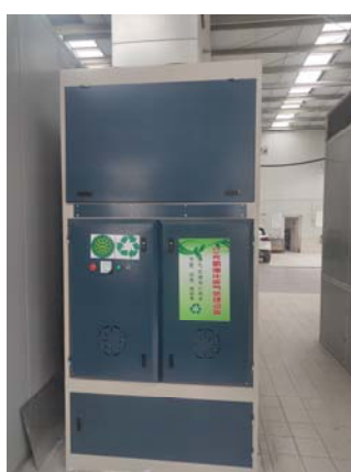
1#漆房废气治理设备
